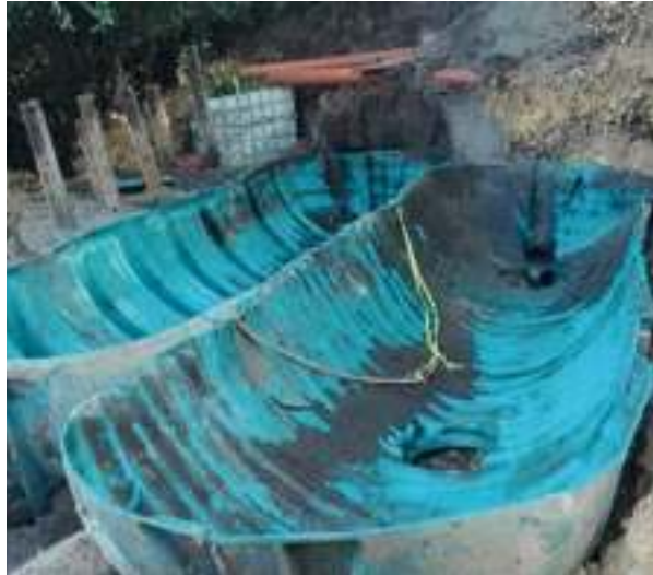
Colocación de las dos mitades de la fosa séptica para implantar el sistema de depuración, tras vaciado y corte de la misma.
