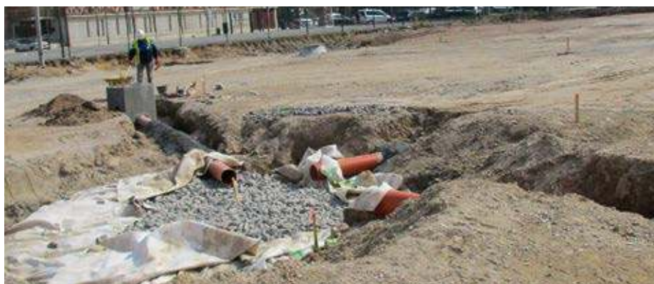
Sistema de conducción de agua pluvial mediante tubos de PEAD que vierten a la columna de grava.
