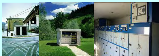
Centro de transformación
