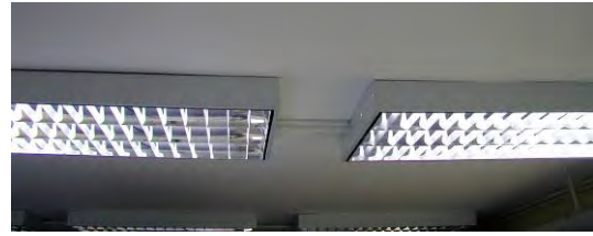
Imagen ilustrativa de la tipología de luminaria de oficina evaluada
