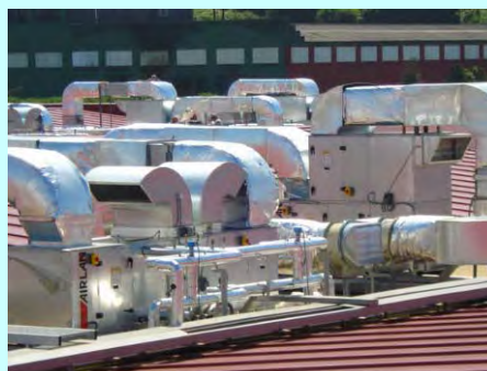
Central de tratamiento de aire
