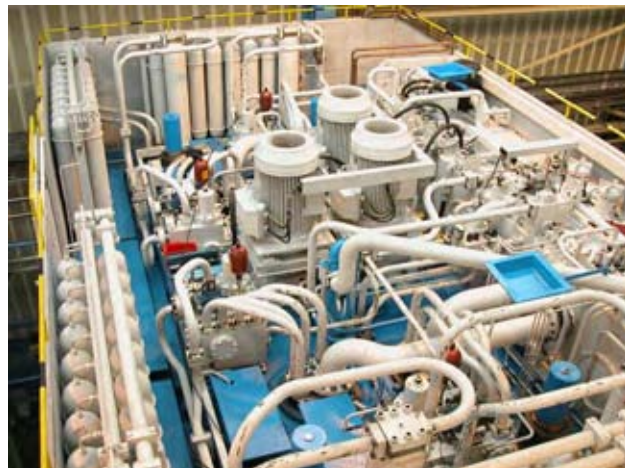
Grupo hidráulico de una prensa colocada en el cabezal de la máquina. Es en este lugar donde se concentra una gran cantidad del aceite que deriva de fugas.
