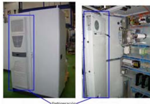
Refrigeración del armario eléctrico por fuera y por dentro. Fuente: TEKNIKER
